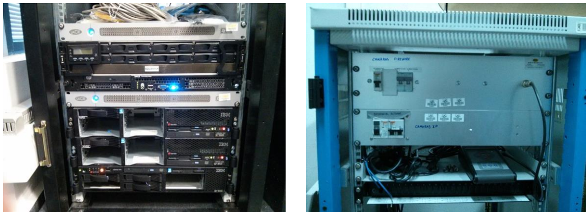
Figura 11. Detalle de equipos de proceso (izda.) y del punto de acceso y control de parte de las cñamaras (dcha.).
